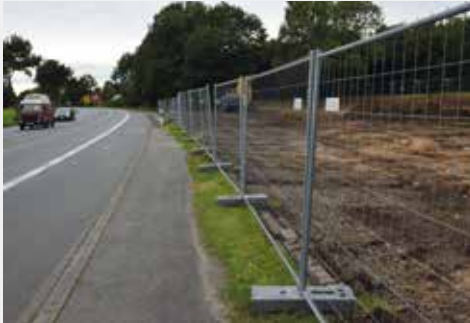
Die Erdarbeiten an der B 64 Richtung Delbrück haben begonnen. Anfang des Jahres 2016 soll dort eine neue Tankstelle eröffnet werden.
